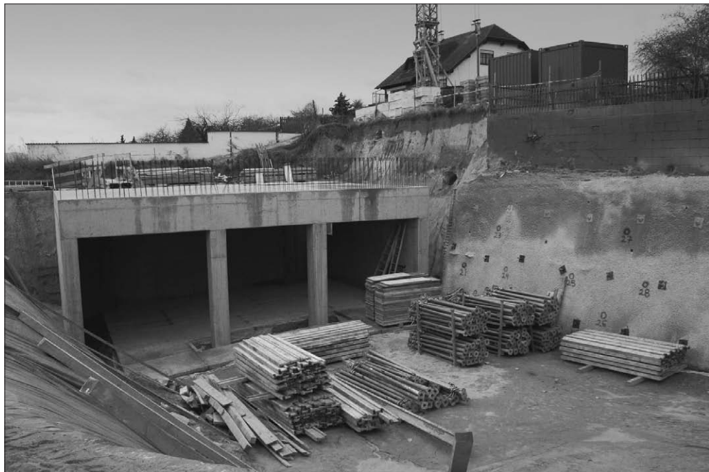
Abb. 7: Krems-Wachtberg. Grabungskeller im Bauzustand 2008/9 (Foto: Prähistorische Kommission der Österreichischen Akademie der Wissenschaften).
