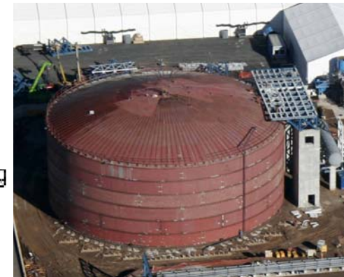
Flüssigsalztank Andasol 1 (Spanien)
