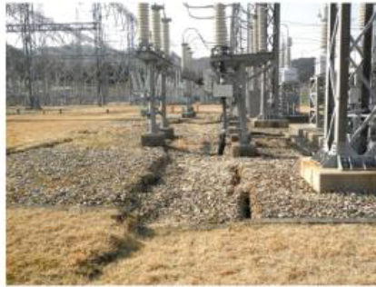
撮影：東京電力株式会社 H23.3.12
