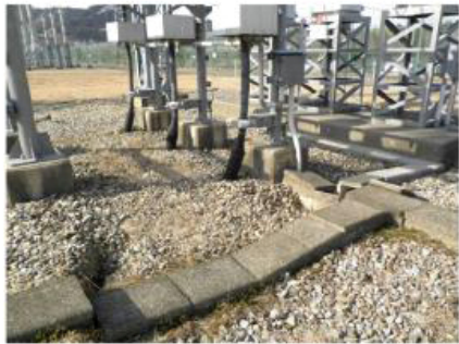
撮影：東京電力株式会社 H23.3.12
